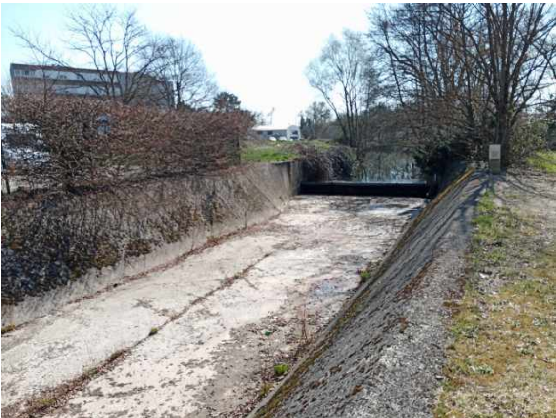
Figure 28 : vanne de régulation actuelle côté Canal de Loëze
